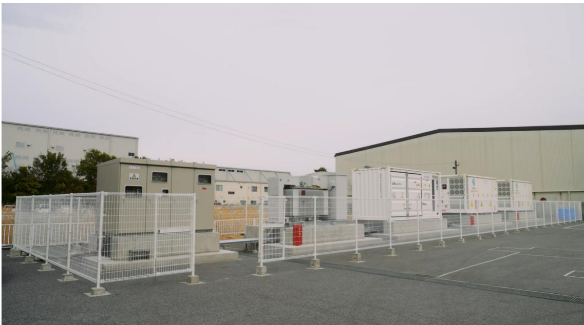
M&K Energy が運用する館林蓄電所
